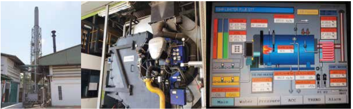
รูปที่ 2 หม้อต้มไอน้ำ ใช้พลังงานเชื้อเพลิงจาก LPG และมีระบบควบคุมมลพิษทางอากาศ
