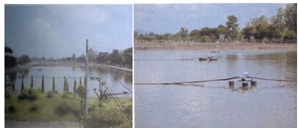
ระบบบำบัดน้ำเสียของเทศบาลนครเชียงราย
