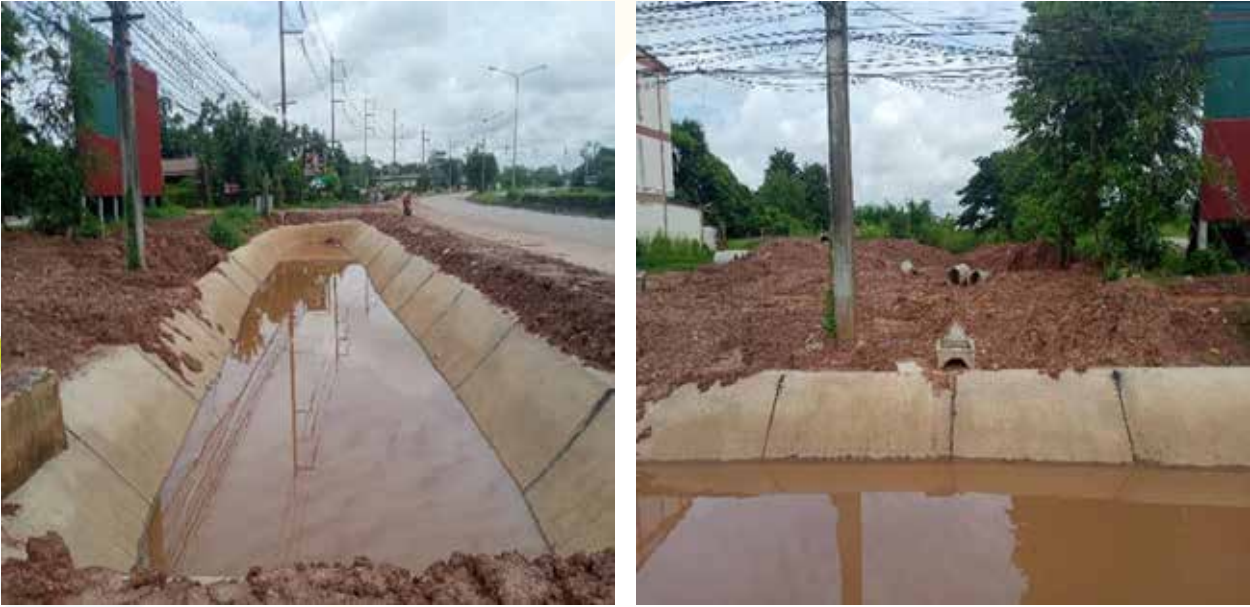
ภาพที่ 13 การวางท่อระบายน้ำของกรมทางหลวงที่ไม่มีการเชื่อมต่อกับท่อระบายน้ำของทางเทศบาลเมืองหนองสำโรง ทำให้เกิดการปิดกั้นทางระบายน้ำของชุมชนและเป็นสาเหตุให้เกิดน้ำท่วมขัง
