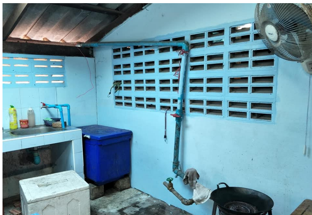
ภาพที่ 3.5 การต่อท่อก๊าซชีวภาพมายังหัวเตาสำหรับก๊าซชีวภาพด้านในห้องครัว
