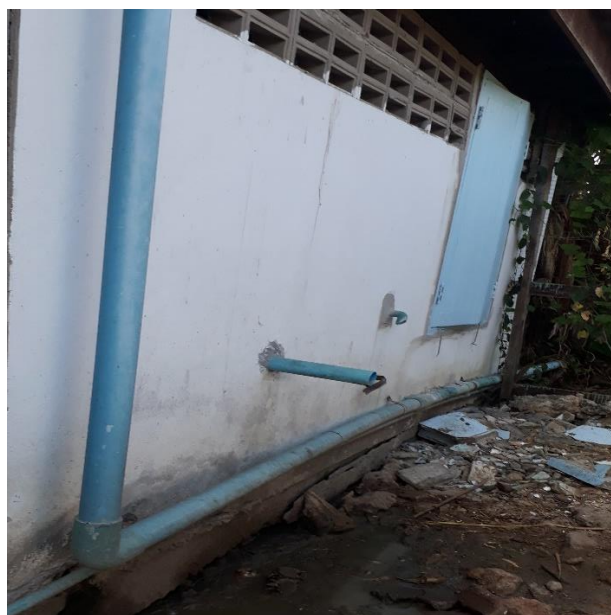
ภาพที่ 3.4 การต่อก๊าซชีวภาพจากบ่อหมักก๊าซชีวภาพเข้าห้องครัวของโรงเรียนบ้านห้วยยาง
